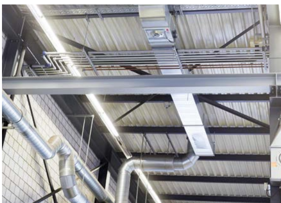
La ventilation artificielle permet d'assurer une aération suffisante.
